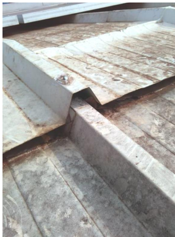
Figura 3 – Afastamento entre telhas adjacentes decorrente do trânsito contínuo diretamente sobre as mesmas
